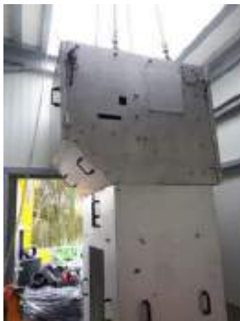
Nouveaux dégrilleurs au poste Sud
